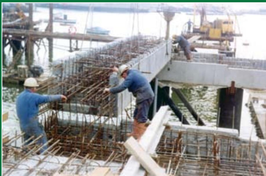
Construction de l'élevateur : une structure imposante soutenue par d'énormes tubes remplis de béton enfoncés à moins cinq mètres des plus basses mers. Document SECMAR.
